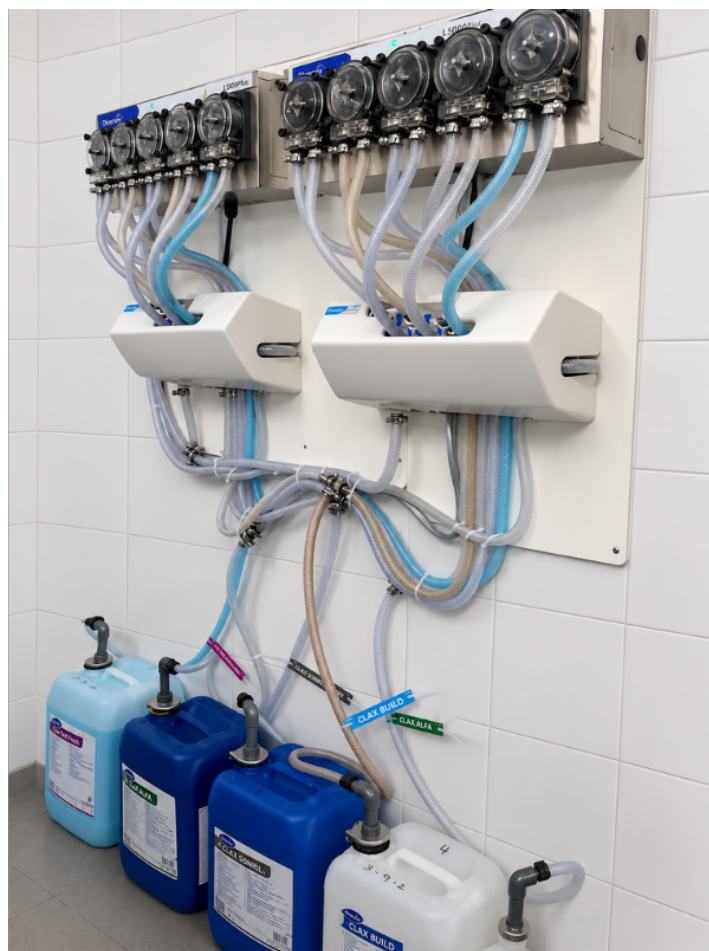
Detalle del equipo L5000 y de las líneas conectadas a distintos productos líquidos de lavandería.
