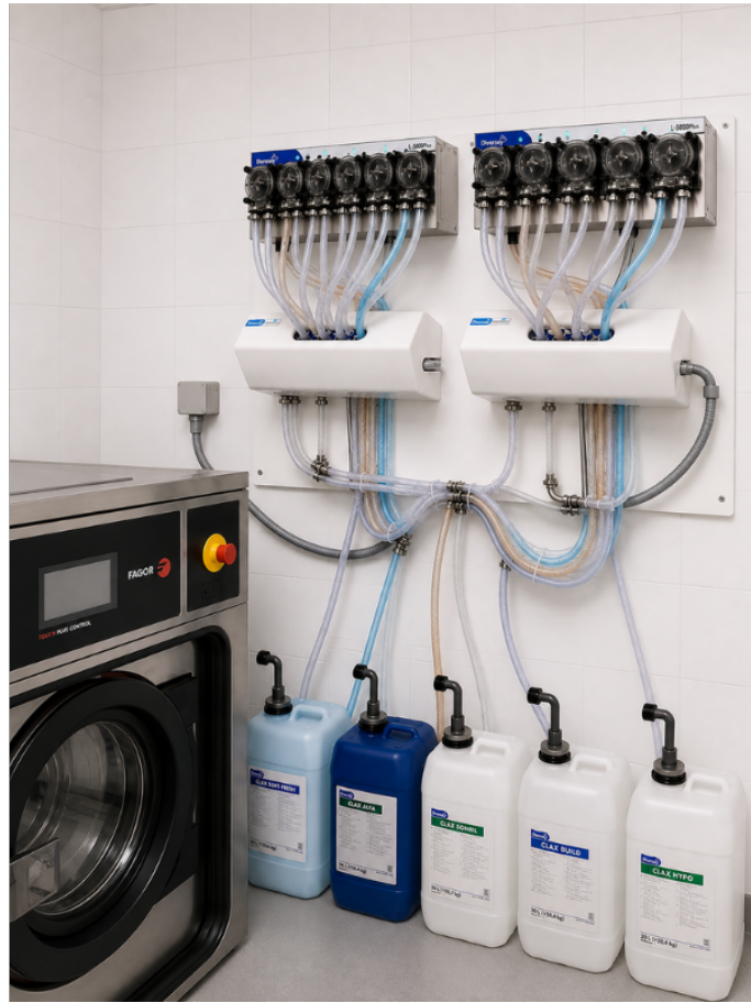
Instalación de lavandería profesional con equipos de dosificación automática L5000.
